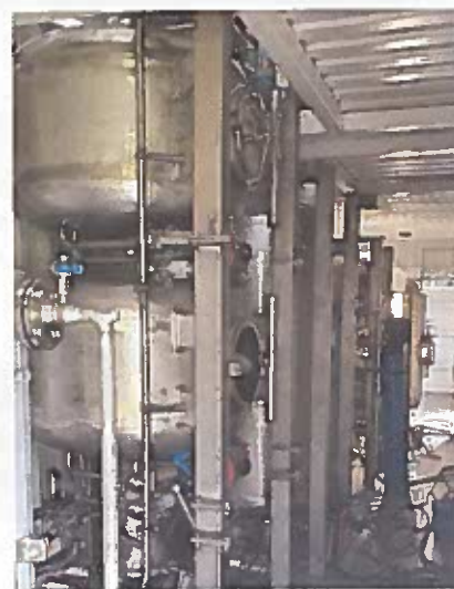
I KOLONNE: Et nærbilde av hydrolysereaktorene i kolonne.
