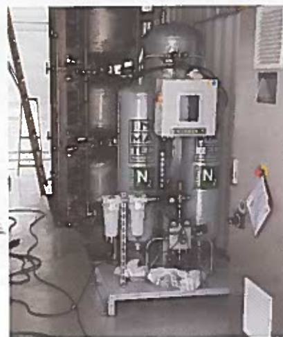
INNSIDEN: Inne i den ene containermodulen. Hydrolysereaktorene i bakkant med nitrogenanlegg for forkant.
